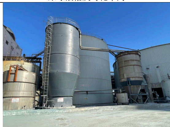
白液储罐及白液澄清器
