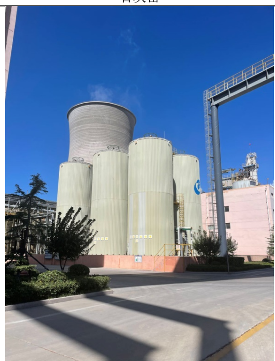
二氧化氯罐区
